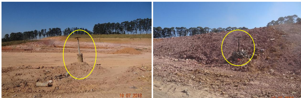
Figura 123 - Sistema de drenagem de gases: (A e B) Drenos com flares na área do maciço.
