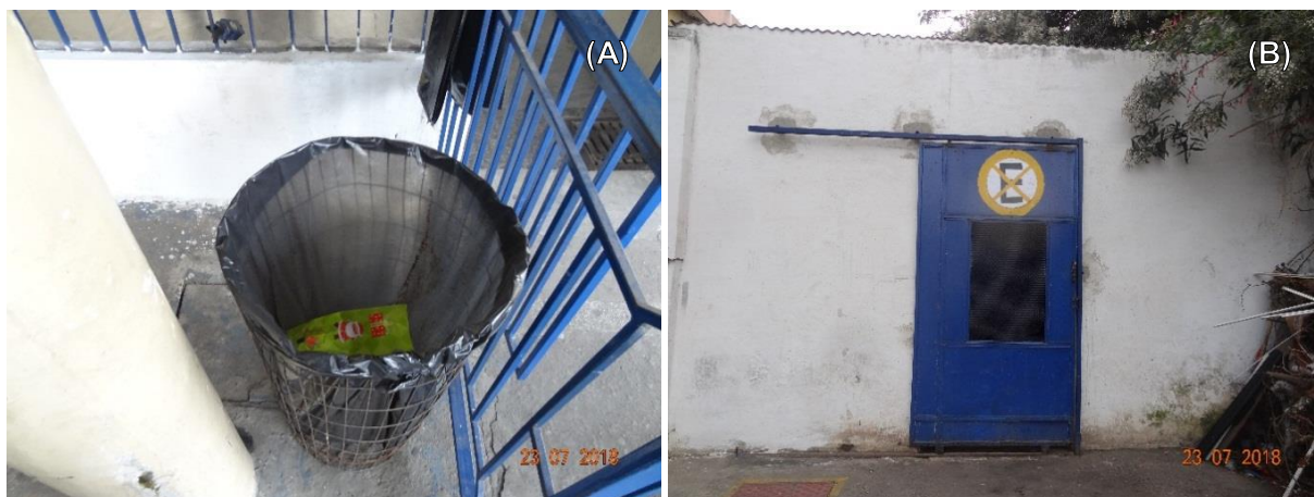
Figura 82 – Terminal Rodoviário de Guaratinguetá: (A) Recipiente de acondicionamento de resíduo; e (B) Abrigo de resíduos externo.
