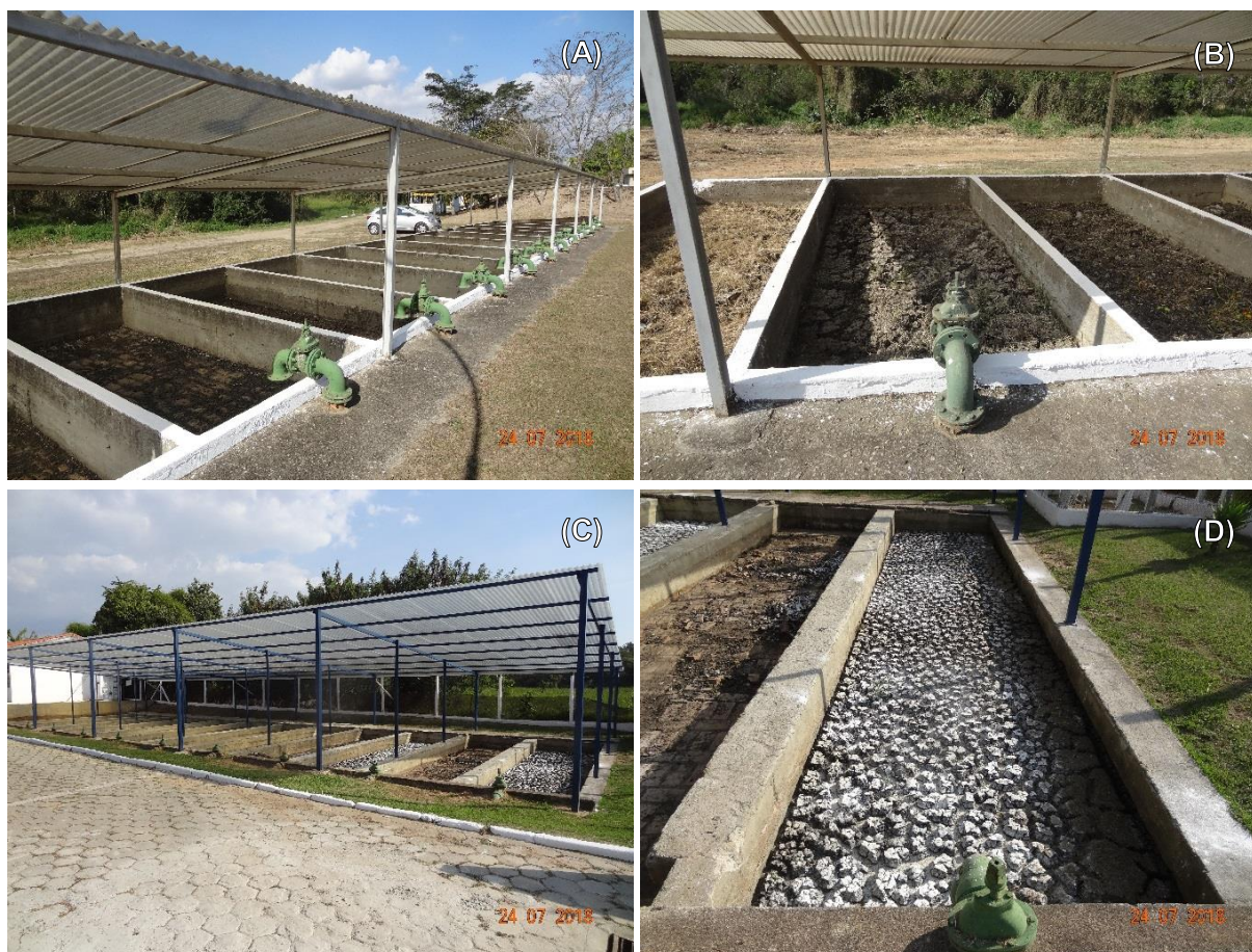
Figura 58 – Sistema de tratamento de lodo: (A e B) Leito de secagem da ETE Vila Bela; e (C e D) Leito de secagem da ETE Campo do Galvão.
