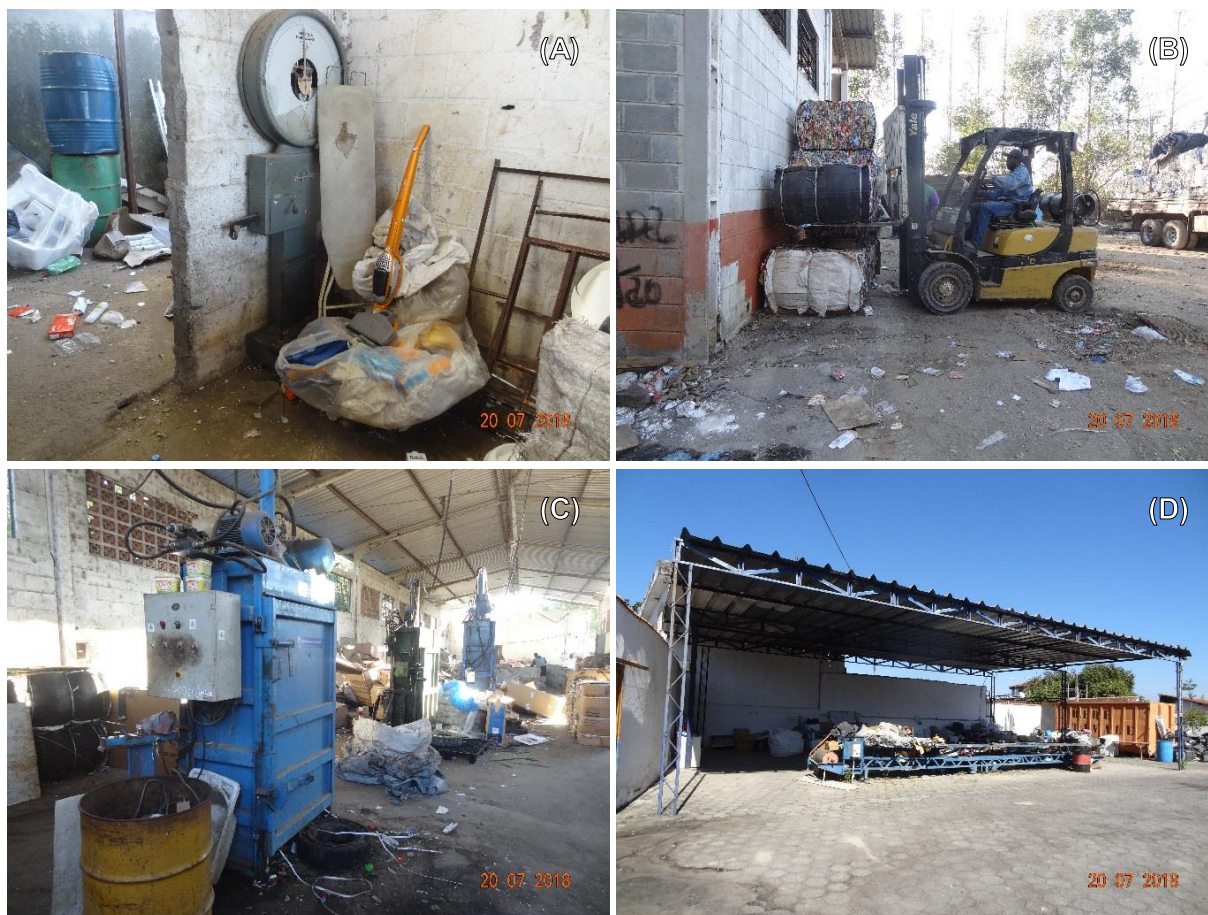
Figura 28 – Equipamentos da Cooperativa Amigos do Lixo de Guaratinguetá, sendo: (A) Balança mecânica; (B) Empilhadeira; (C) Prensa hidráulica vertical; (D) Esteira que encontra-se em espaço físico do Ecoponto Municipal, sendo utilizada para acondicionar recicláveis.
