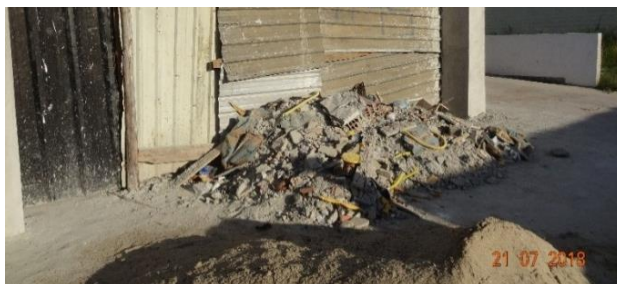
Figura 73 – Forma irregular de acondicionamento de resíduos da construção civil sob o solo em frente ao local da obra no bairro Campo do Galvão.
